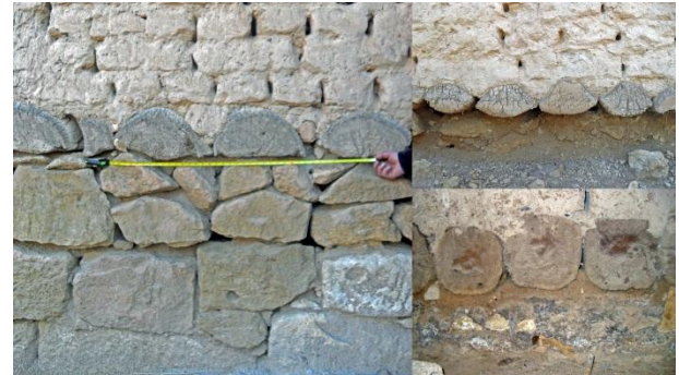
Figure 3.8: Mur mixte à assise en bois de palmier, variantes des dispositions, Biskra, Algérie (Haoui Samira)
